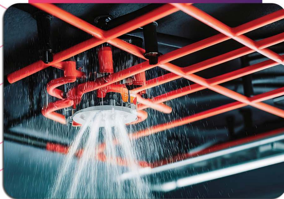
أنظمة مكافحة الحريق
