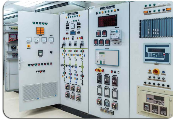
أنظمة توزيع الطاقة الكهربائية (LV/MV Panels)
