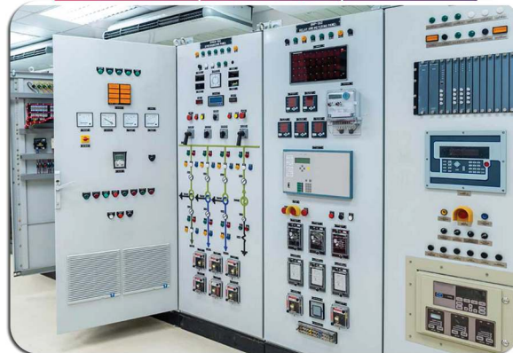
أنظمة توزيع الطاقة الكهربائية (LV/MV Panels)
